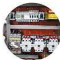
Figura 55 – Quadro de comando
