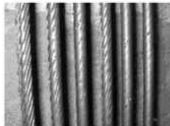
Figura 41 - Cabos de aço com o conhecido “tubo preto”. Excessivamente lubrificados e sujos.
